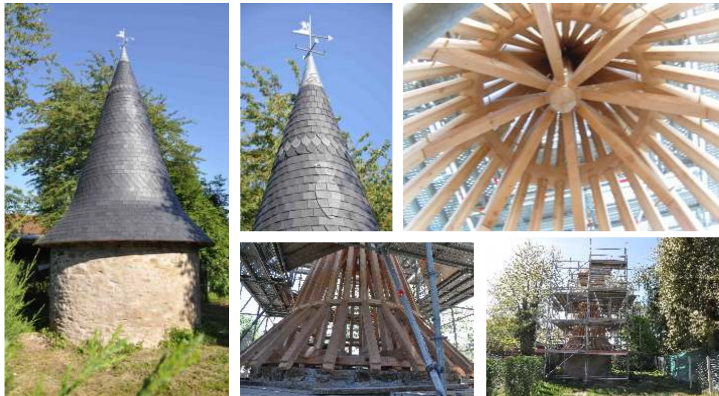
Magnifique travail de restauration effectué par des Compagnons Charpentiers et par un artisan couvreur. Admirez le détail dans la toiture en ardoises, une amphore, symbole de Saint-Gence ! Faites un détour par Senon pour voir ces chefs d'oeuvre !
